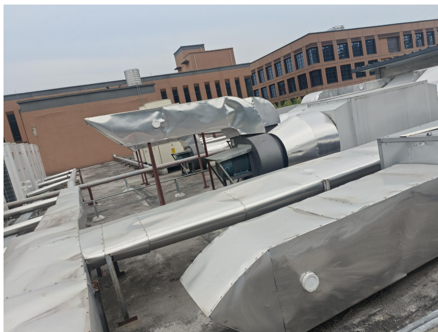
图 3-4 废气处理设施照片
