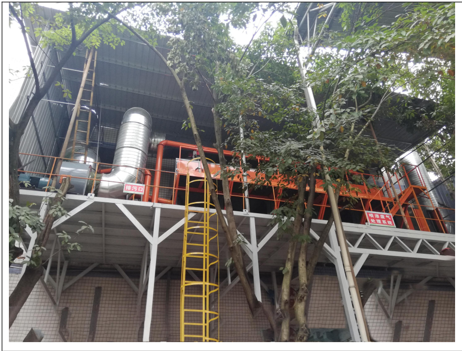
图 3.4 废气处理设施图
